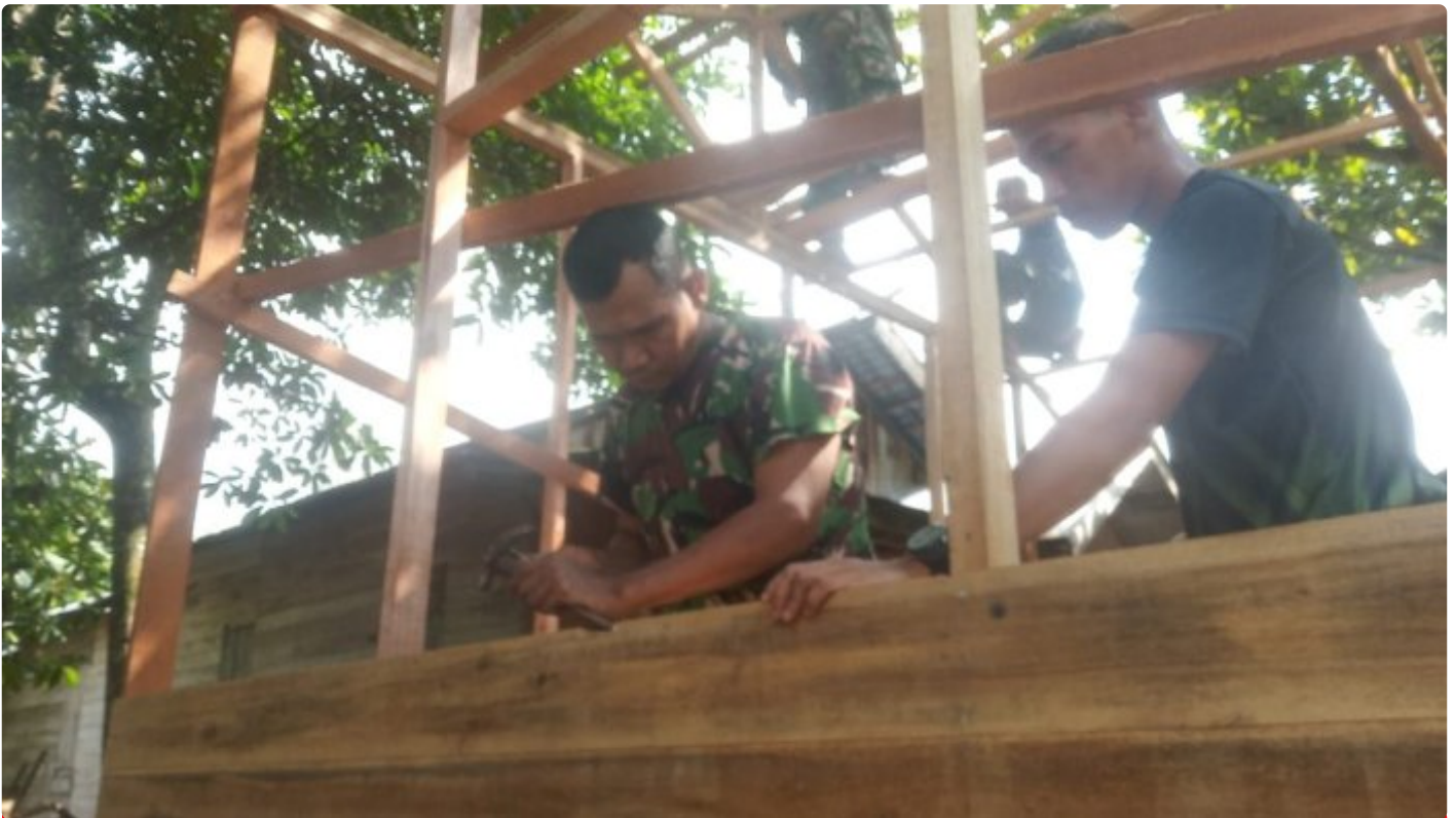
Rehab Tidak Layak Huni TMMD Ke-116 Kodim HST Pasang Dinding Dan Lantai Rumah
